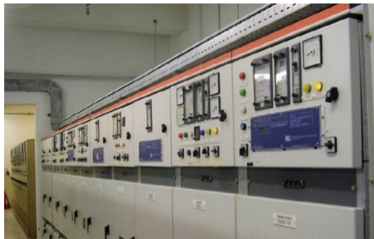
Figure 5 : Les relais SEL protègent tous les actifs importants du système électrique de MOH.
