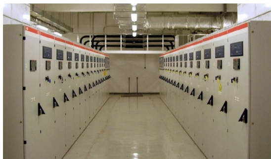
Figure 3 : Pour les nouvelles installations, MOH a demandé aux fabricants des appareillages de commutation d'acheter et d'installer les relais de protection SEL.
