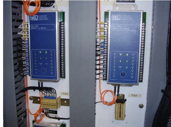
Figure 6 : Des modules E/S ultra-haute vitesse, montés à distance, ont été installés sur le site pour le système de délestage POWERMAX de SEL. Ces modules E/S de contrôle, qui sont configurés avec des commutateurs DIP, disposent de contacts de sortie de déclenchement, de communications dédiées, de blocs d'alimentation embarqués et de fonctions complètes d'auto-surveillance pour assurer le plus haut niveau de fiabilité possible.
