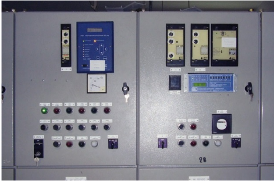
Figure 4 : Pour mettre en place une nouvelle solution haute vitesse économique, MOH a abandonné le mécanisme de protection et de mesure existant, puis a installé de nouveaux relais SEL dans l'appareillage de commutation.
