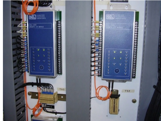
Figura 6. Para el sistema de tiro de carga SEL POWERMAX se instalaron módulos E/S de ultra alta velocidad, montados de forma remota en toda la planta. Estos módulos E/S, configurados con microswitches (DIP Switch) de control, tienen contactos de salida con capacidad de disparo, comunicaciones dedicadas, suministro integrado de energía y auto-monitoreo para proporcionar máxima confiabilidad.
