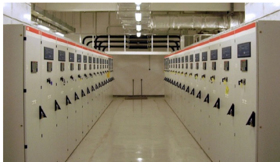
Figura 3. MOH instruyó a los fabricantes de interruptores que compraran e instalaran relés de protección SEL para las nuevas instalaciones.
