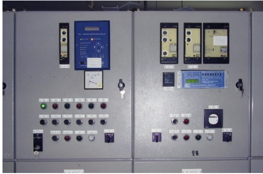
Figura 4. Para lograr un reacondicionamiento económico y de alta velocidad, MOH abandonó la protección y las mediciones existentes e instaló nuevos relés SEL en los conmutadores.
