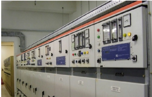
Figura 5. Los relés SEL brindan protección a todos los principales activos del sistema eléctrico de MOH.
