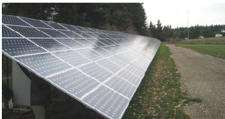
Figura 1. Paneles solares en la autopista solar de PGE.
