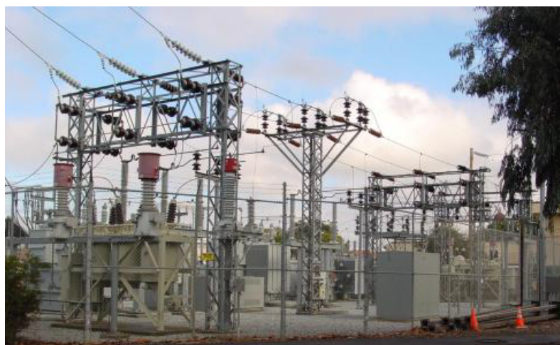
Figura 7 Subestação Palou—Disjuntor a Óleo (OCB) Obsoleto, à Esquerda
