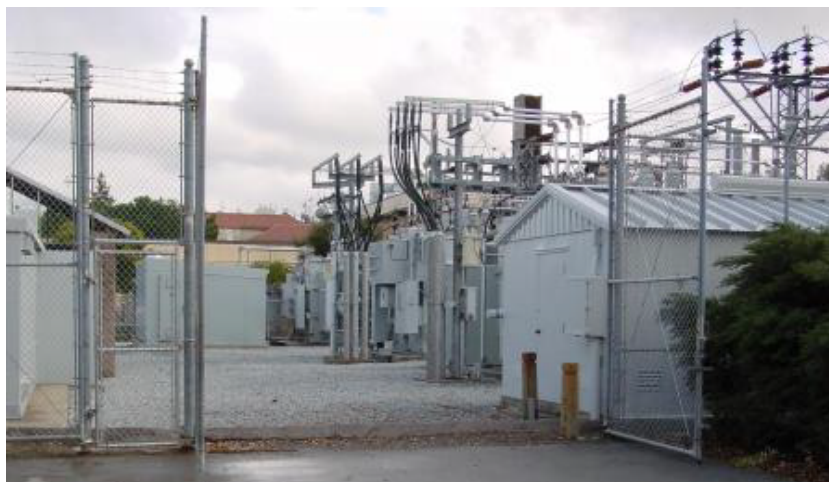
Figura 5 Subestação Palou, Fevereiro de 2004 (Bancos de Transformador 1, 2 e 3, da Esquerda para a Direita)
