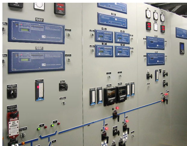
Figura 9 Subestação Palou – Novos Painéis de Proteção e Controle
