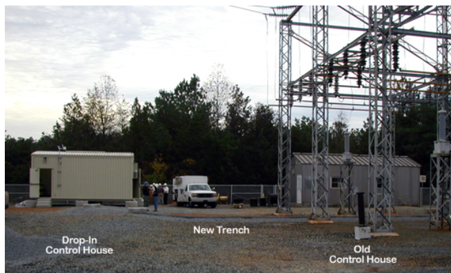
Fig. 2. Casas de Controle Antiga e Nova na Subestação Belmont Tie
