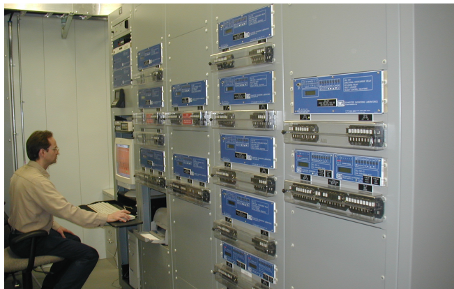
Fig. 3. Configuração do Painel Dentro da Casa de Controle
