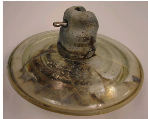
Fig. 29. Isolador danificado a 38,16 milhas a partir do terminal Goshen.
