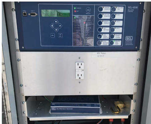
Figura 7 — SEL-FR12 instalado no painel de controle do religador SEL-651R.
