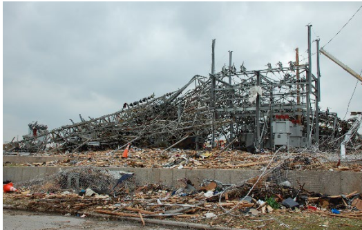
Рисунок 2. Подстанция Empire на 26-й улице Джоплина после торнадо (Джейс Андерсон/FEMA)
