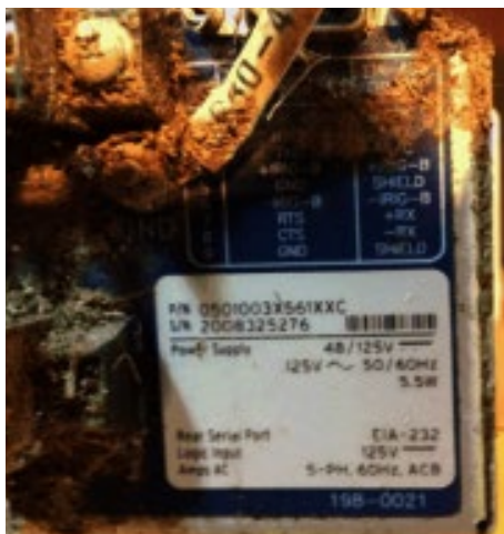
Figure 3 : relais SEL-501 qui a survécu à une tornade EF5
