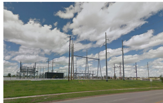
Figure 4 : poste électrique de la 26e rue à Joplin récemment reconstruit par Empire (Google)
