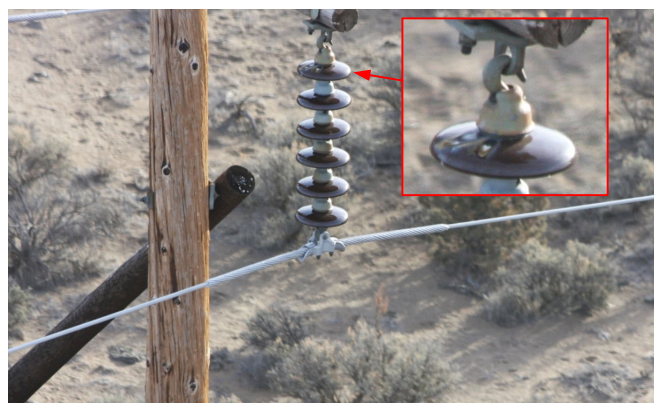
Fig. 12. Descarga no isolador da fase C, torre 8/6 (oitava torre após a sexta milha) da linha Brasada-Harney.
